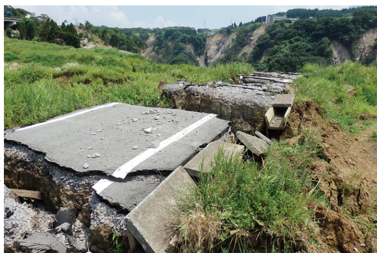
アスファルトが寸断され、通行不能になった農道。地震の大きさを物語っている
