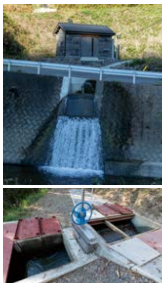
日之影町の急峻な地形と大人用水路を利用して立ち上げた大日止昇小水力発電所
